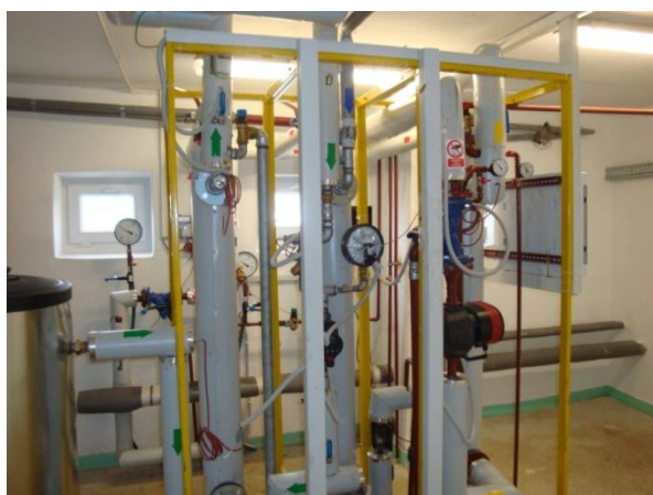
Węzeł ciepły, fot. z archiwum PEC w Suwałkach Sp. z o.o.
